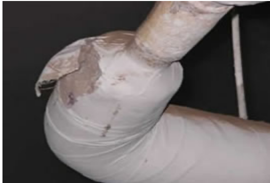
Torn asbestos pipe lagging
